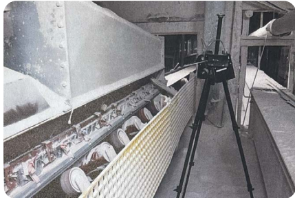
Instalación de los instrumentos de medición tras la instalación del sistema AirScrape®.
