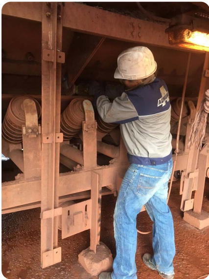
Preparación para la instalación del sistema AirScrape mediante pequeñas modificaciones estructurales metálicas en el punto de transferencia.
