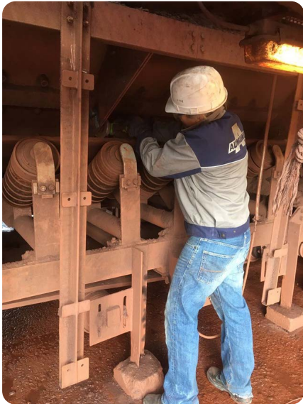
Vorbereitung für die Installation des AirScrape-Systems durch kleinere metallbauliche Anpassungen an der Übergabestelle.
