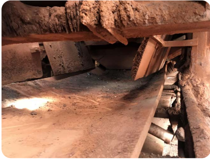
Die Übergabestelle vor der Installation: Materialaustritt in alle Richtungen durch unzureichende Abdichtung.
